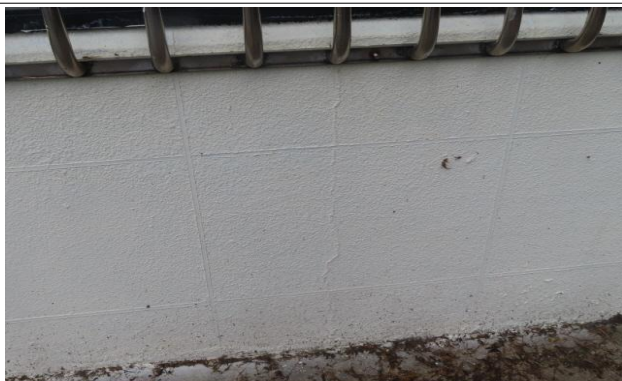
계단실 및 전기실 외부 마감재 균열
