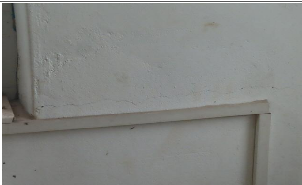
전기실 벽체 몰탈균열
