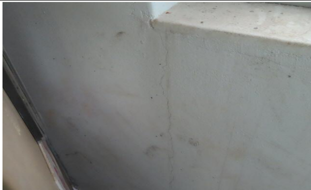
전기실 벽체 몰탈균열
