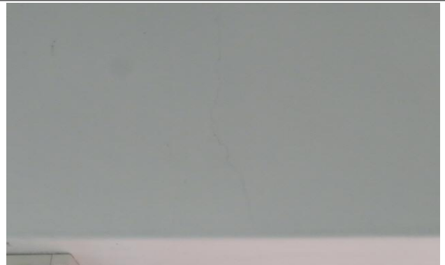
전기실 벽체 몰탈균열
