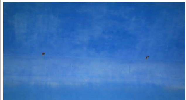
배수지 1지 상부슬래브 녹
