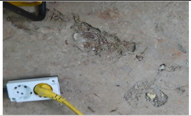
전기실 하부슬래브 몰탈박리
